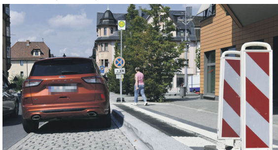
Ab sofort entfallen zugunsten des Busverkehrs die in Fahrtrichtung rechts befindlichen Parkbuchten. Foto: C.-H. Zitzmann
