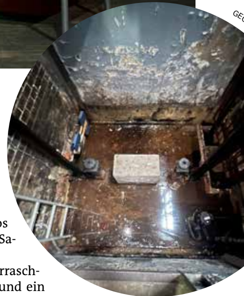
Dieses Foto kann man riechen: Wasserschaden im Keller des Rudi-Dutschke-Hauses
