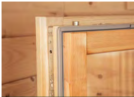
Fenster- und Türdichtung
