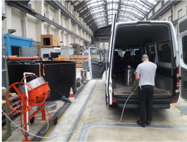
Abbildung 29: Rückspülung über 10 µm Sieb durch ROSI
