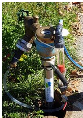
(c) Standrohr mit Wasserzähler und Schwebekörperdurchflussmesser
